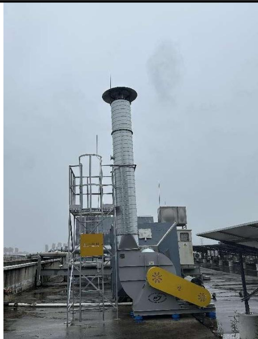
图 3-3 废气处理设备照片
