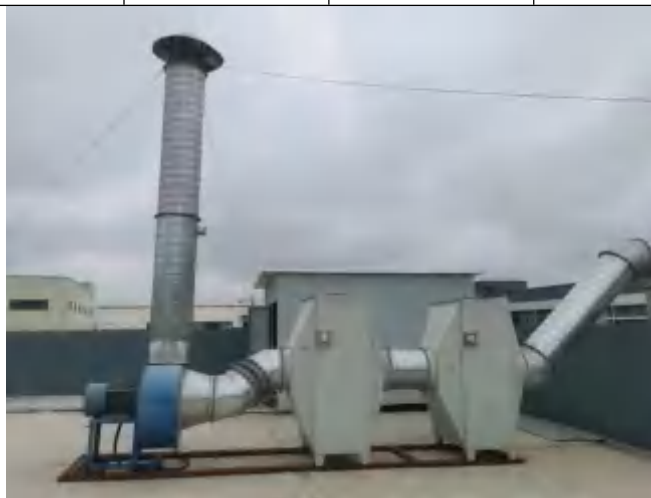
图 3-1 废气处理设备照片
