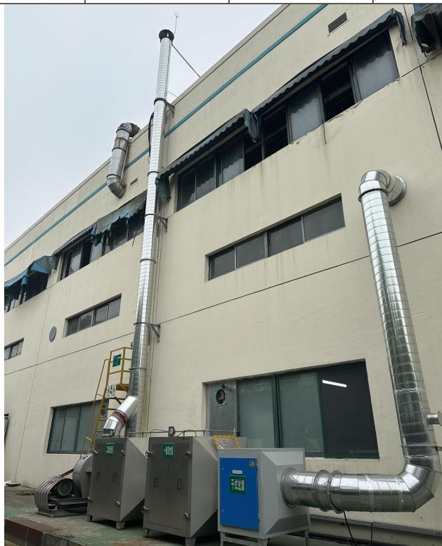
图 3-1 废气处理设备照片
